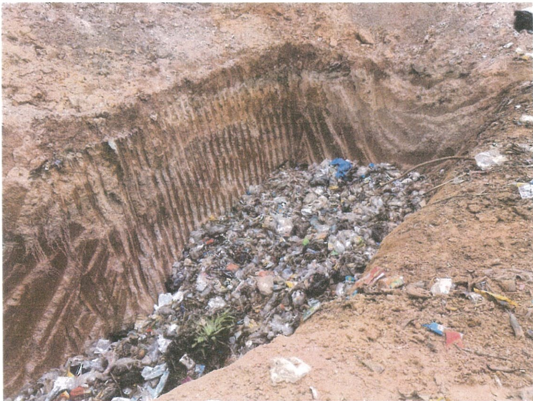
สภาพพื้นที่บ่อกำจัดขยะมูลฝอยบริเวณพื้นที่สาธารณประโยชน์ หมู่ที่ 10 เทศบาลตำบลหนองแวงแก้มหอม
